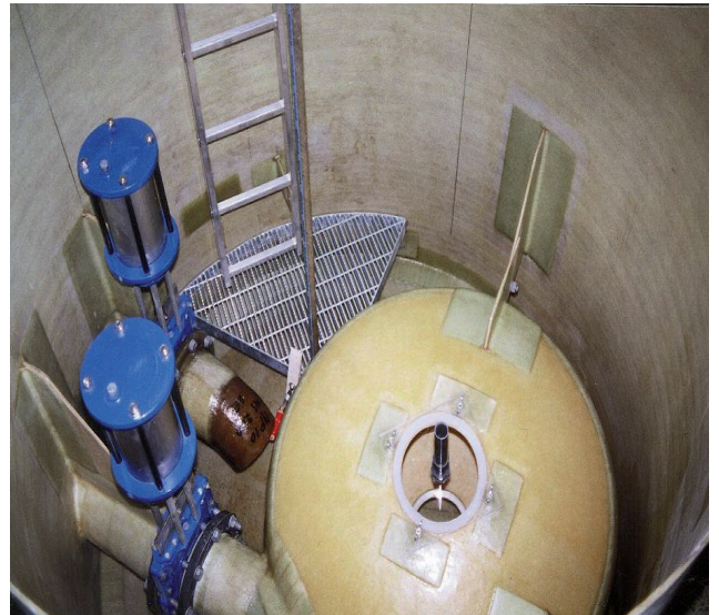
Avløpsregulator (Foto: MFT, Miljø- og Fluidteknikk AS)
