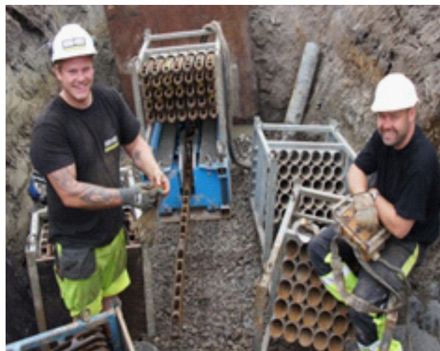
Bilde 3: Mottaksgrop med trekkestag som demonteres etter hvert som nytt rør installeres i gammelt rør.
