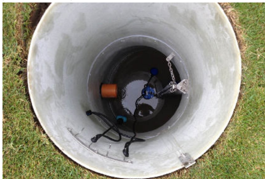
Figur 4. Pumpekum med vippestyrt pumpe og alarm for høyt vannivå. Foto: NIBIO.
