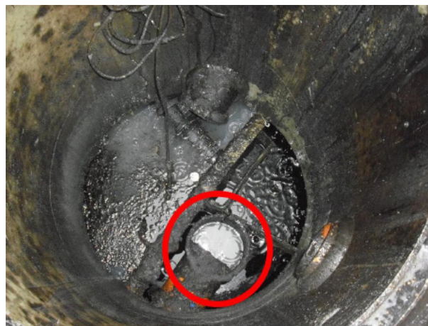
Figur 5. Utskiller med utløpskasse uten lokk. For øvrig et anlegg som ikke er tømt og rengjort.
