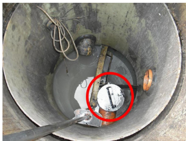
Figur 6. Samme anlegg som i figur 5, etter tømning og med montert lokk på utløpskassen.
