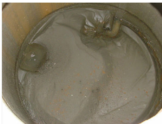
Figur 4. Dårlig vedlikeholdt sandfang med manglende tømning. Anlegget er overfylt med sand/slam.
