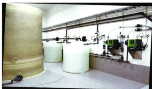
Figur 7: Klorproduksjonsanlegg samt måling av restklor
