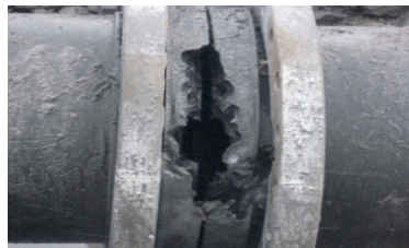
Figur 6: Eksempel på skade på PE-krage som følge av lekkasje i standard løsning med krage og løsløp. Mediet er i dette tilfellet er slurry fra gruveindustri, som er svært eroderende.
